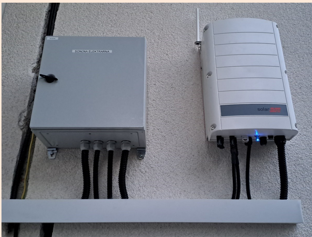
Slika 7: Omarica sončne elektrarne (levo) in razsmernik (desno), ki pretvarja enosmerno napetost v izmenično napetost
