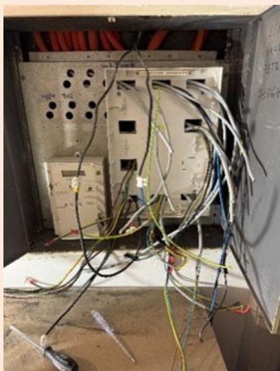
Slika 1: Stanje stare klasične inštalacije
