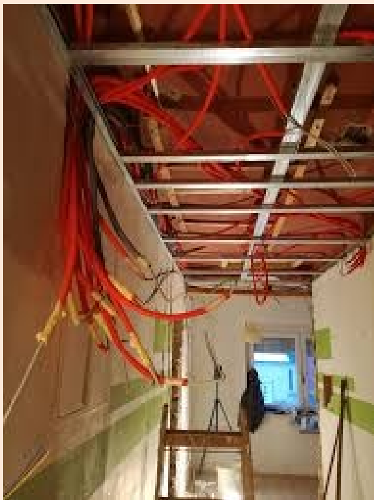
Slika 11: Povečana nevarnost požara
