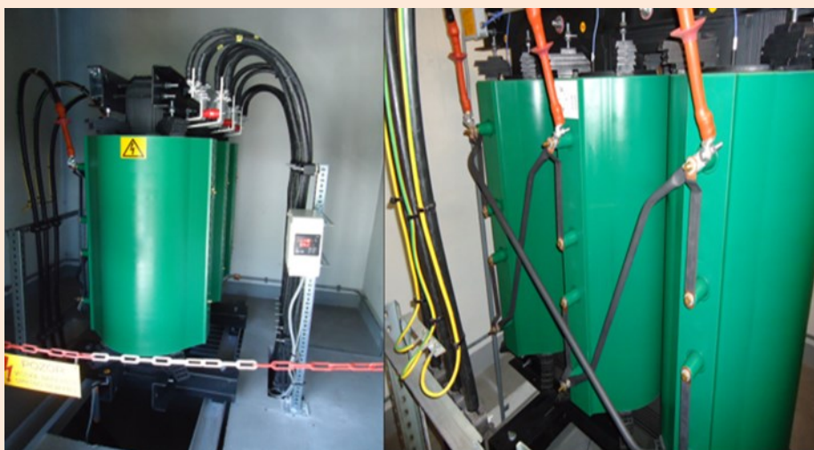
Slika 6: Izgled vgrajenega suhega transformatorja
