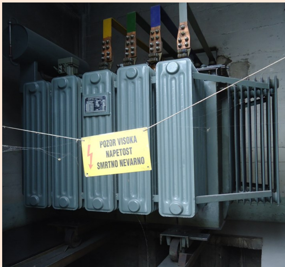
Slika 1: Izgled obstoječega energetskega transformatorja
